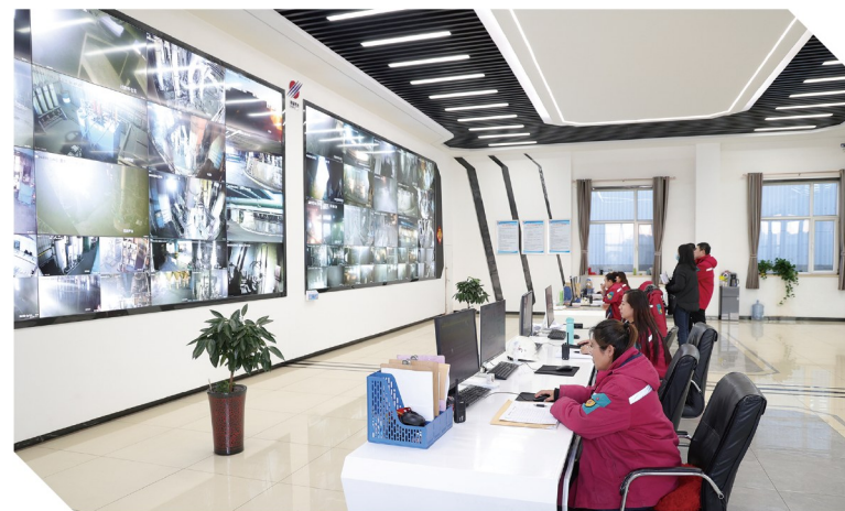
乌兰察布市旭峰新创实业有限公司中控室。
