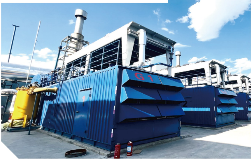
内蒙古瑞源循环产业园内部。
