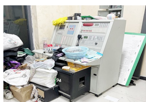
消防控制室控制柜故障，无人值守且堆放杂物
