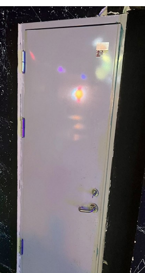
防火门未设置闭门器
